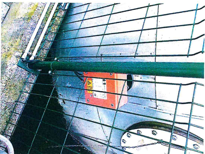
• Lato apertura : accesso limitato (rete + paletto);
